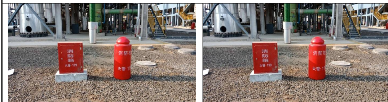
图 4-2 现场应急物资照片
